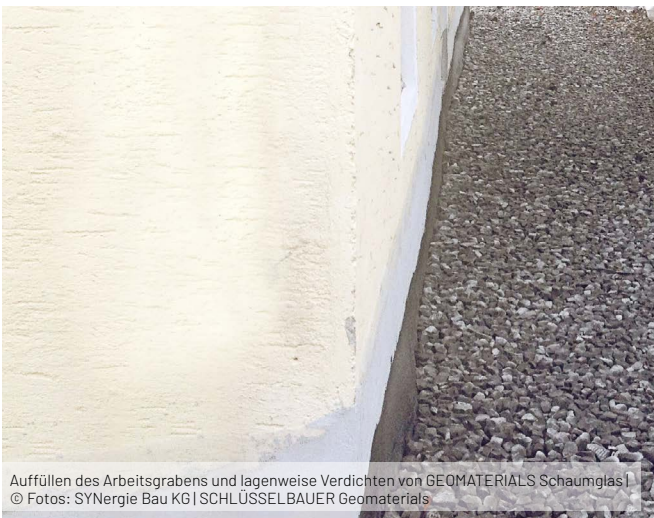
Freilegen des Mauerwerks und Herstellung einer Drainage | © Fotos: SYnergie Bau KG | SCHLÜSSELBAUER Geomaterials
